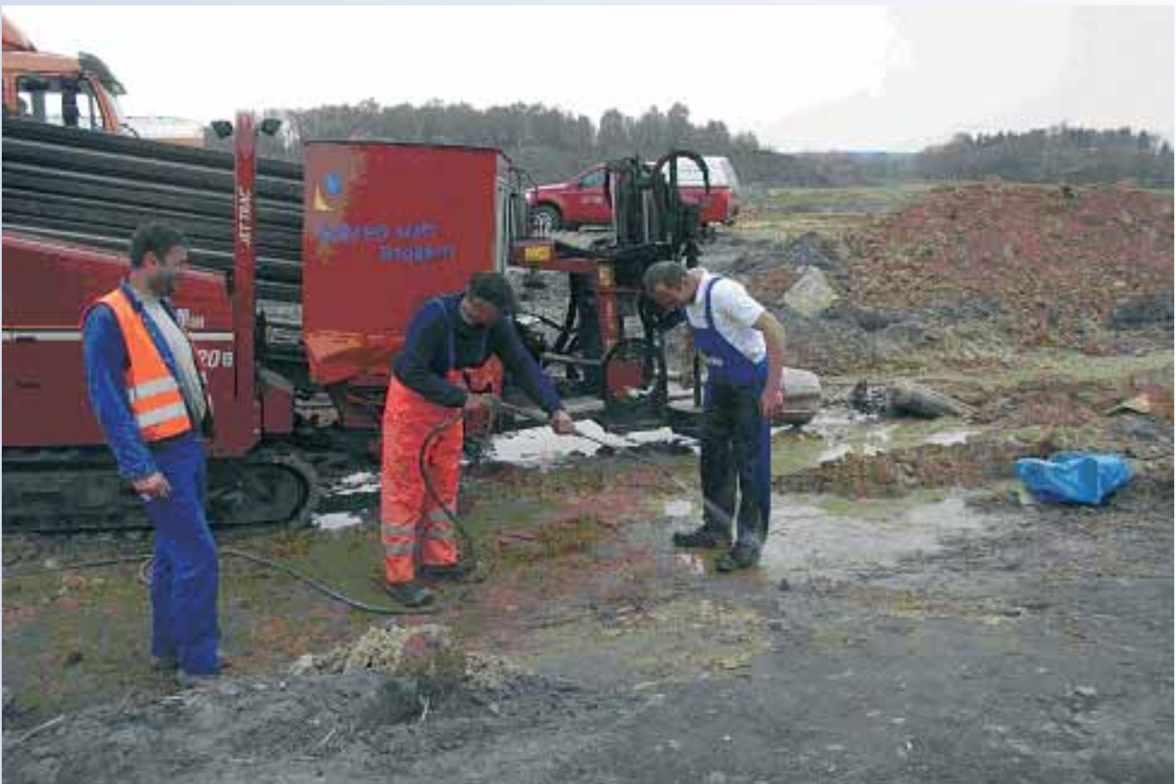
Die Mitarbeiter von Kuhlmann Leitungsbau GmbH und Hoth Tiefbau GmbH & Co. KG arbeiten in jeder Situation Hand in Hand zusammen
