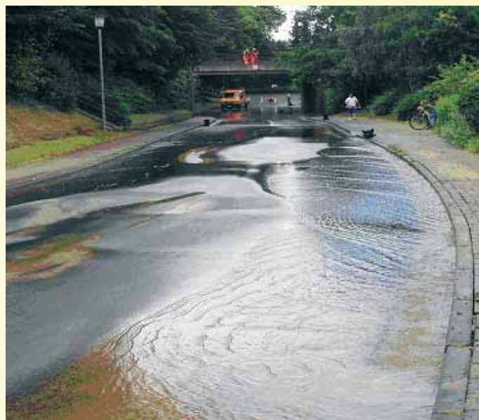
Der Rohrbruch führt zur Vollsperrung der Durchgangsstraße
